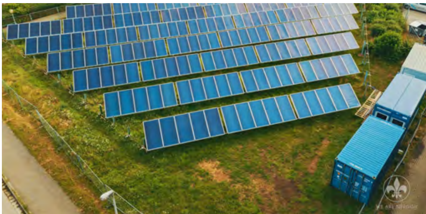
Aufgeständerte Solarthermiekollektoren auf der Grünfläche vor dem Gewerblichen Bildungszentrum (GBZ) in Bruchsal
