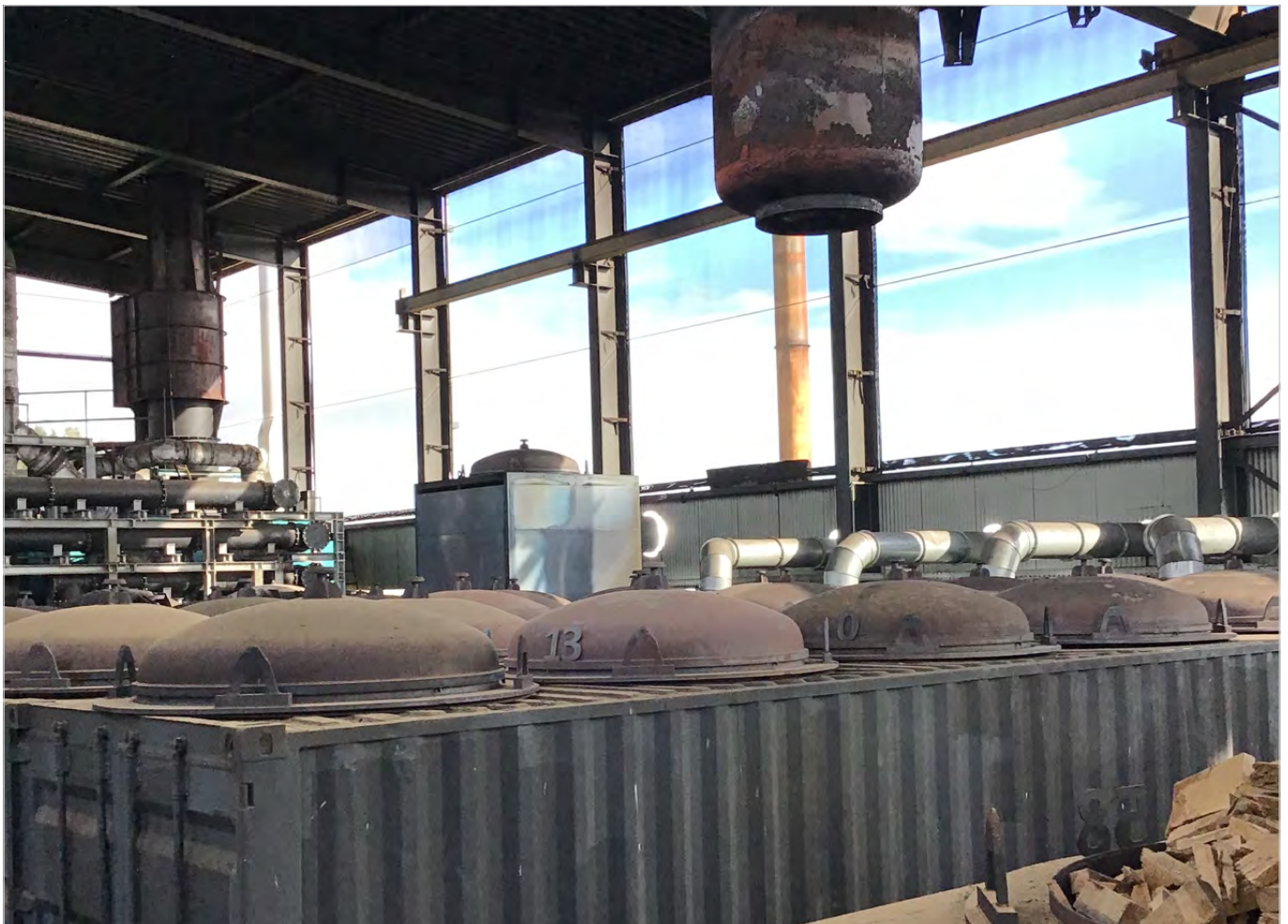
Retorten der Pyrolyseanlage von der Green Carbon GmbH in Üllitz
